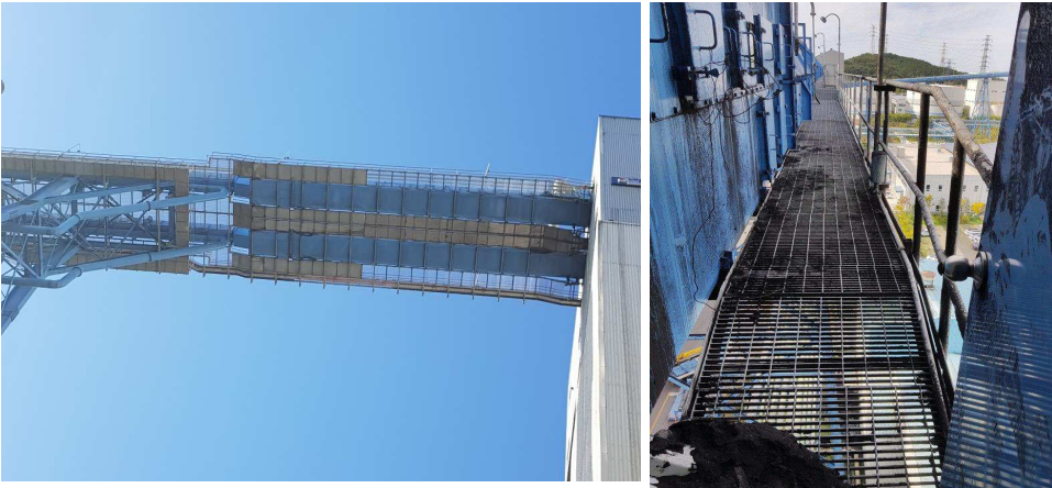
〈높은 곳에 위치한 컨베이어 벨트, 허술한 바닥〉 22)
